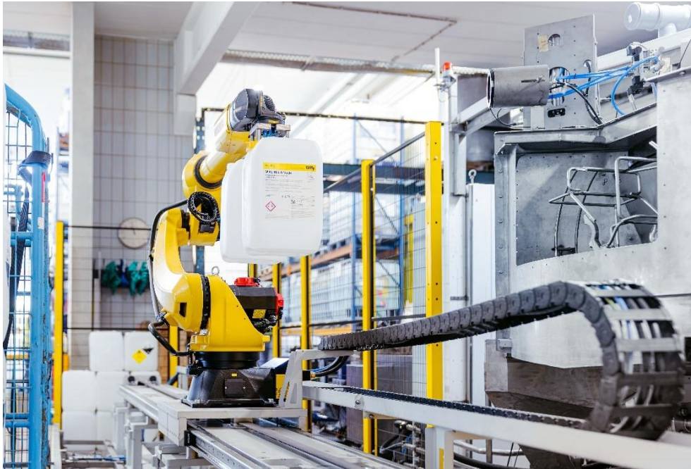
Oben: Die vollautomatische Gebindewaschanlage am Standort Dinkelscherben.
